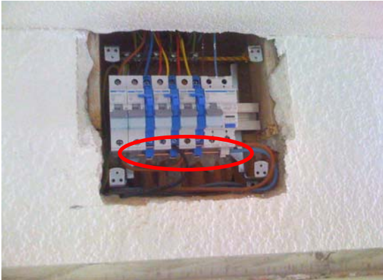
Bild 6 Offene Wohnungsverteilung ohne Berührungsschutz.
