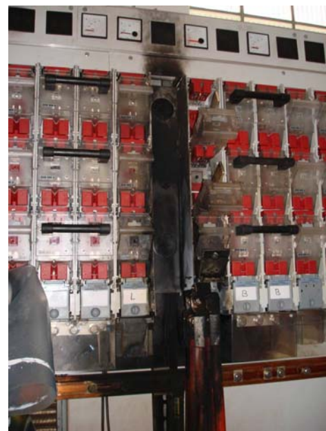
Bild 2 Arbeiten ohne Schutzausrüstung in Niederspannungsverteilung und ohne Abdeckung.
