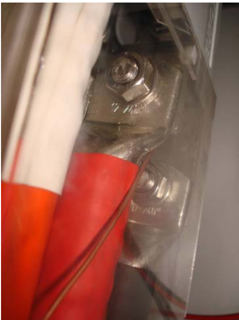
Bild 1 Einzeldraht des Schirms verursacht Kurzschluss mit Flambogen.
